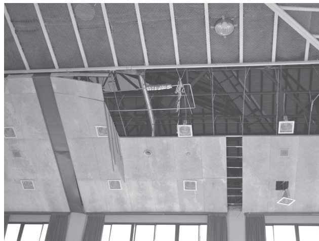
天井が落下した黒羽体育館
