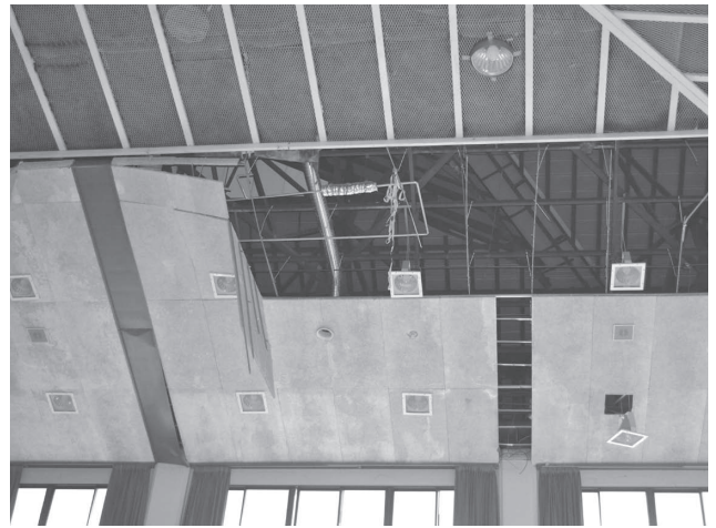
天井が落下した黒羽体育館
