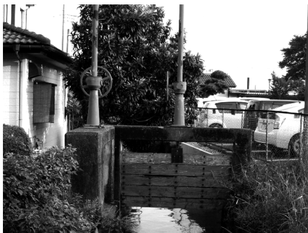
寺町下水路に設置されている手動型水門
